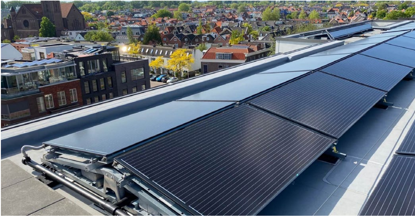
Pvt-panelen gaan steeds meer op zonnepanelen lijken, maar let altijd op de hoogte, de kleur en de wijze van installatie.
